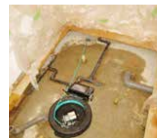
排水管カメラ調査
