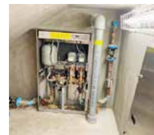
交換前のブースターポンプ
