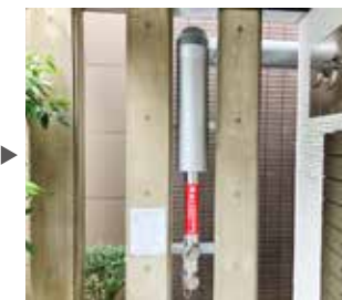
連結送水管完成
