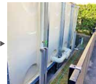
更新後の受水槽
