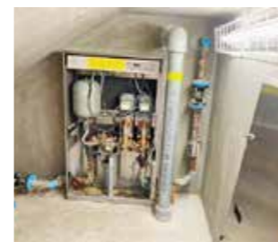
交換前のブースターポンプ
