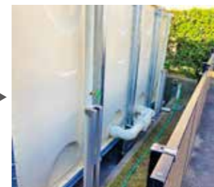
更新後の受水槽
