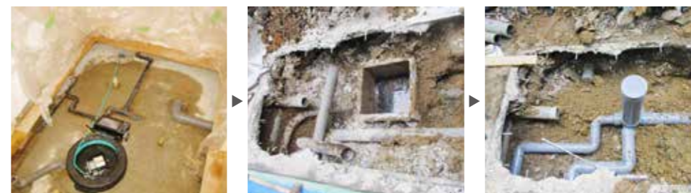
排水管カメラ調査
