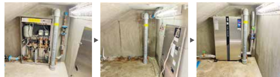
交換前のブースターポンプ
